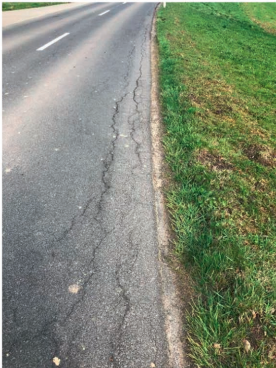
Abbildung 1: Typisches Schadensbild bei zu schmalen Strassen: Abgefahrener Fahrbahnrand im Gebiet Wetzwil.
